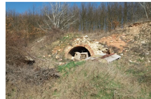
60. fotó: Leromlott állapotú mészégető Pilisszántón
